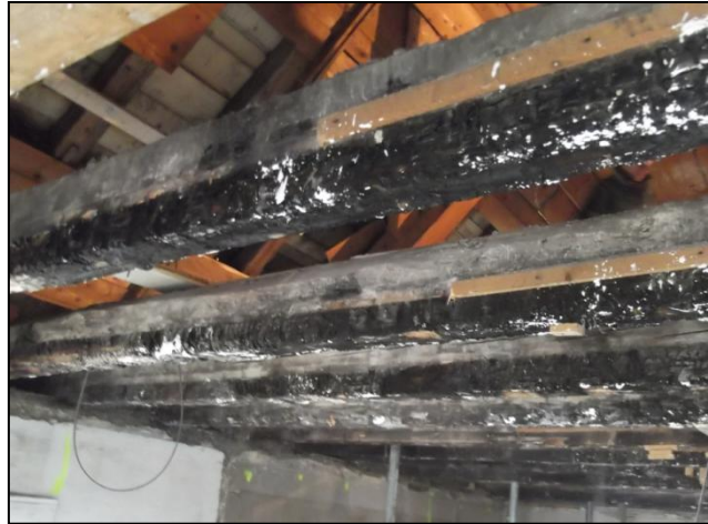
Par endroit, le solivage a été rongé par le feu, vraisemblablement intervenu en 1866.
