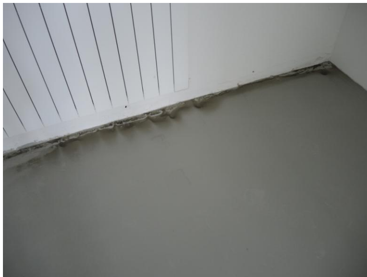
Taches d'humidité / sol de la médiation
